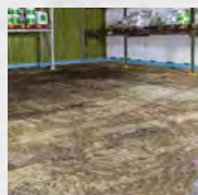
niet dampdicht beton
