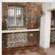
bij vochtig metselwerk
